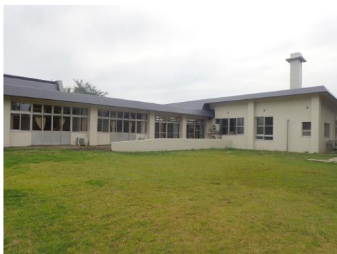
【外壁・居室東側】
